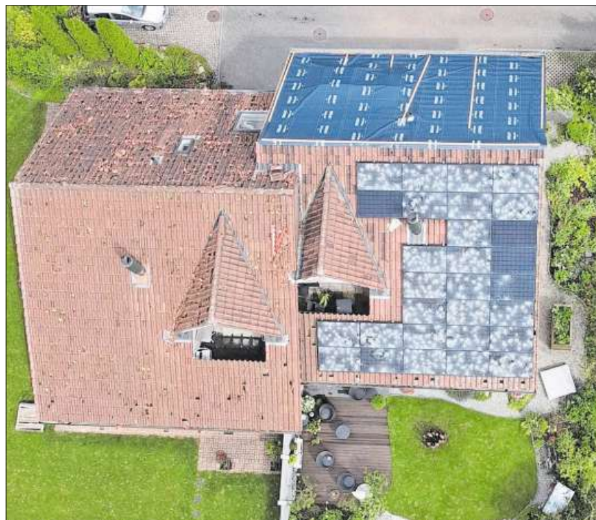
Die Photovoltaikanlage wurde beim Unwetter von 2021 zerstört. Normalerweise übersteht eine PV-Anlage Hagel, nicht aber bei einem Hagelkorndurchmesser von bis zu 9 Zentimetern. Bild: zvg
